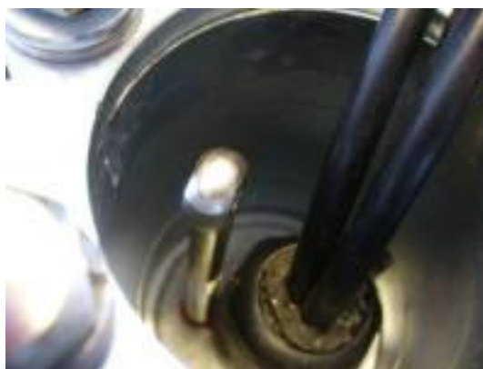
Serre-câbles et boulon de mise à la terre
